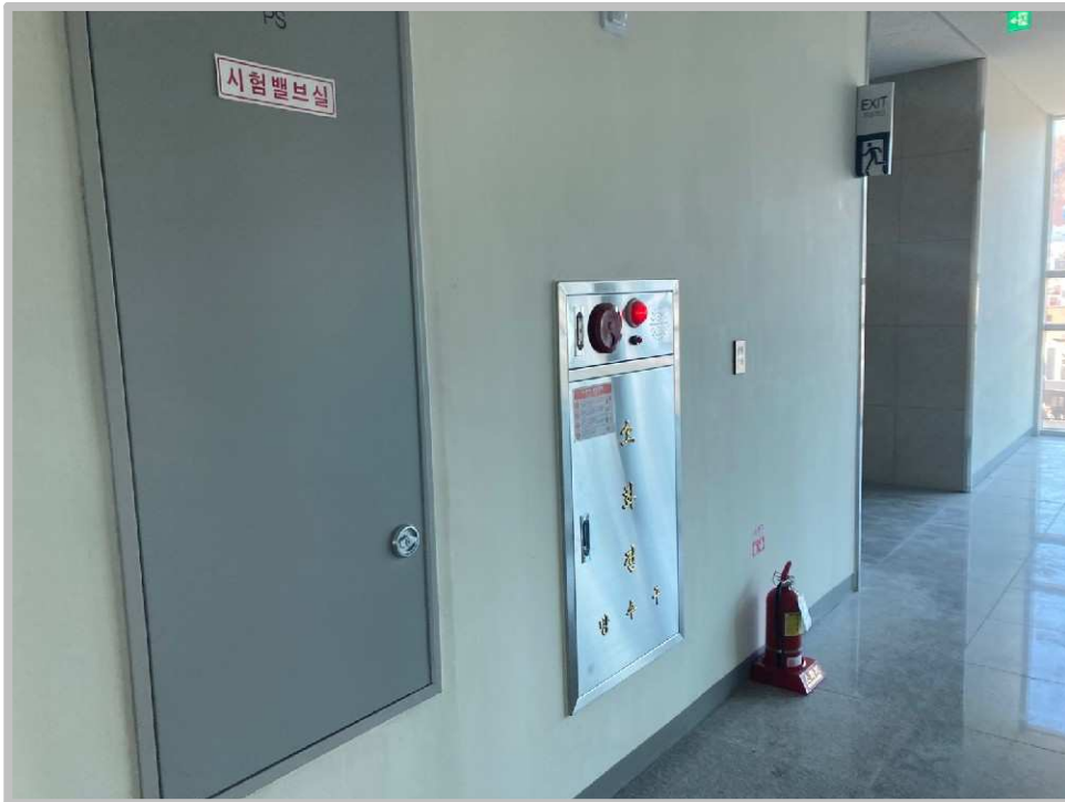
【 본건 소화전 설비 전경 】
